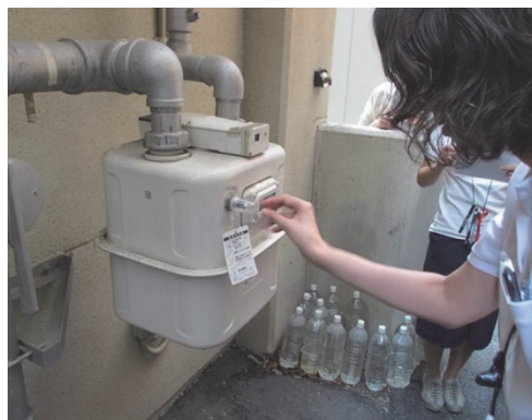
ガスメーター
