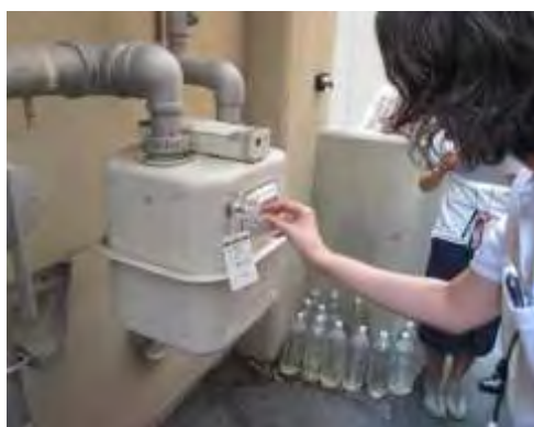
ガスメーター
